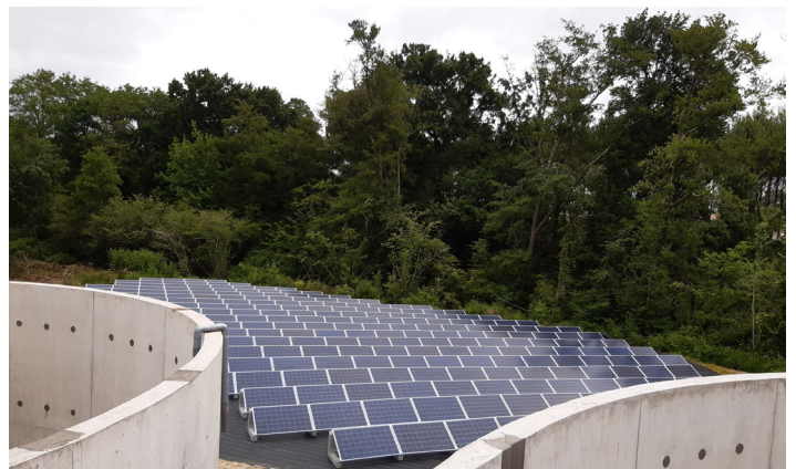
Les panneaux photovoltaïques installés au sol à proximité de la station d'épuration.
