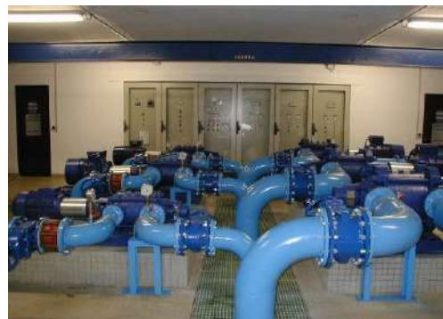
Vue générale de la salle de pompage
